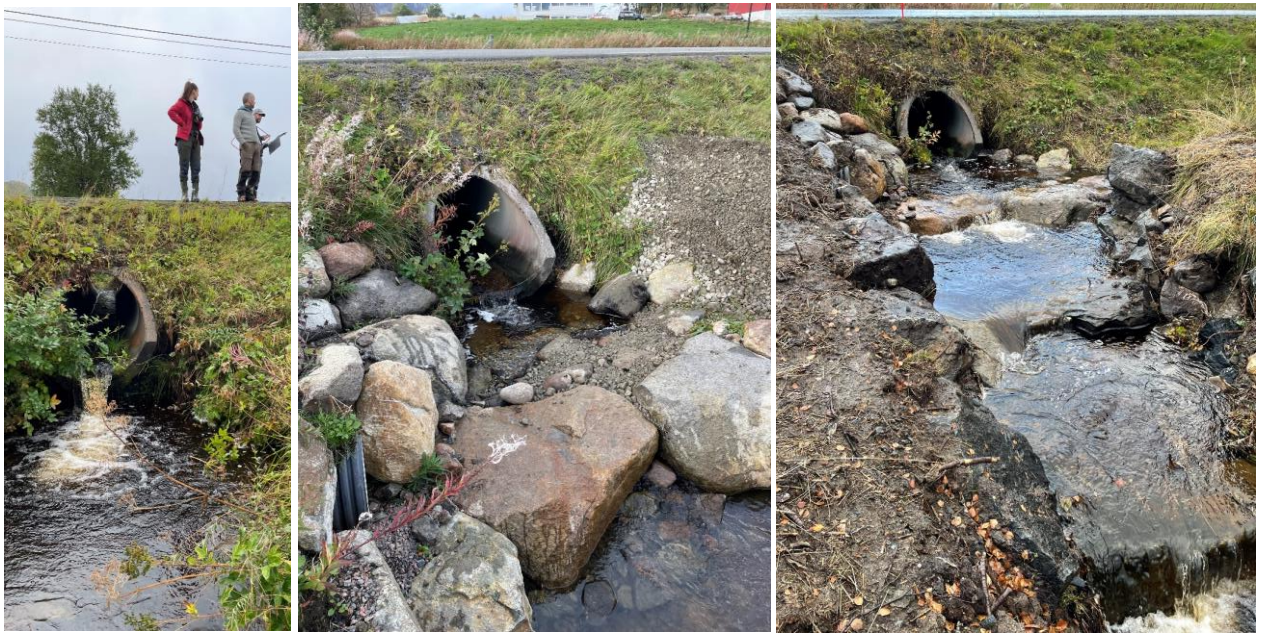
Figur 31 Fiskepassasje ved veikulvert Halselva tillaget 2023, justert og forbedret i 2024.
